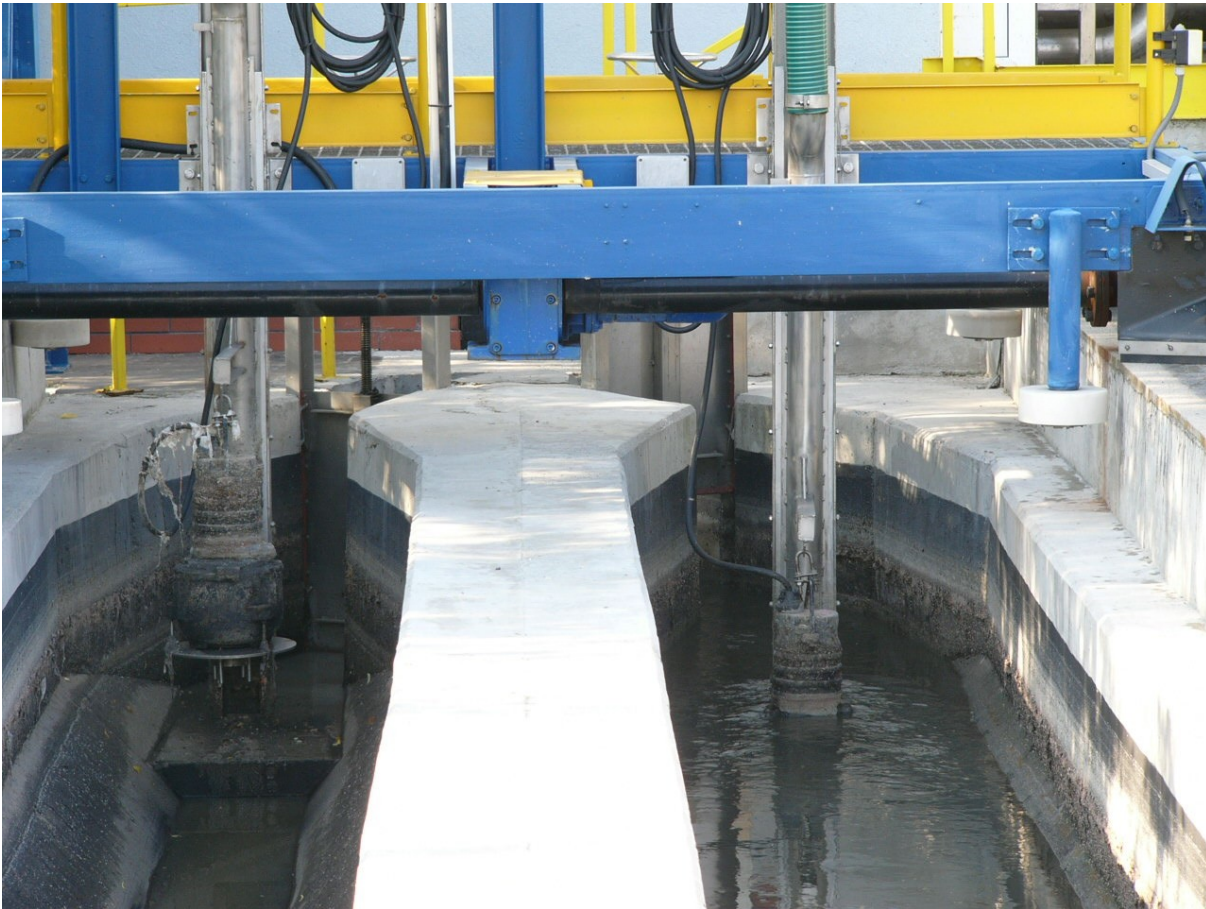
Przewody pomp zatapialnych pompujących pulę piaskową
