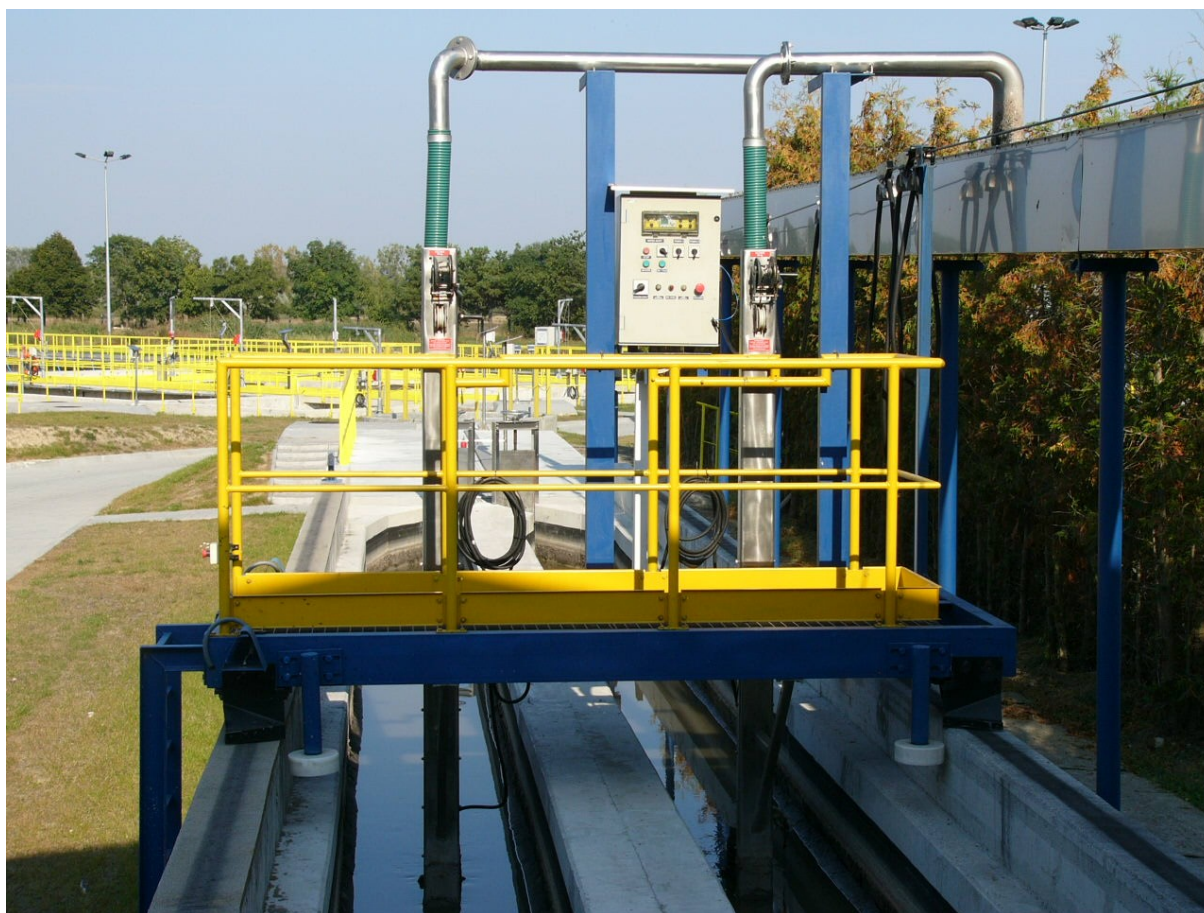
Widok na pomost jezdny zgarniacza piasku oraz koryto powrotne pulpy piaskowej
